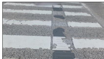
【エスコートゾーンが摩耗している】
