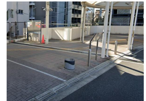
誘導用ブロックの設置不足
