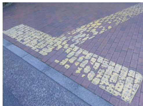
誘導用ブロックの摩耗、劣化
