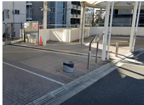
誘導用ブロックの設置不足
