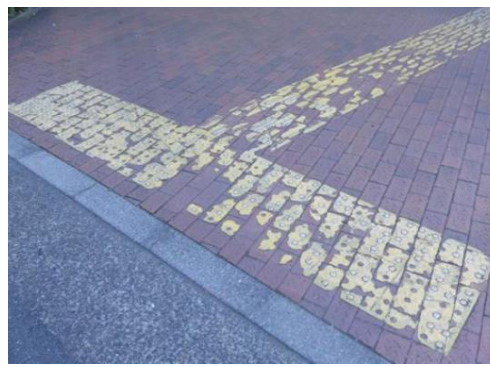
誘導用ブロックの摩耗、劣化
