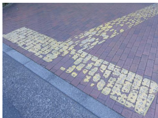
誘導用ブロックの摩耗、劣化
