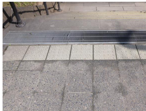
誘導用ブロックを黄色のブロックに改修してほしい
