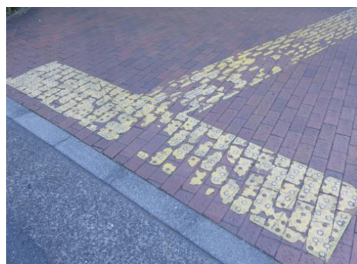
誘導用ブロックの摩耗、劣化
