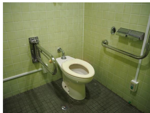
トイレが古いので改修をして欲しい
