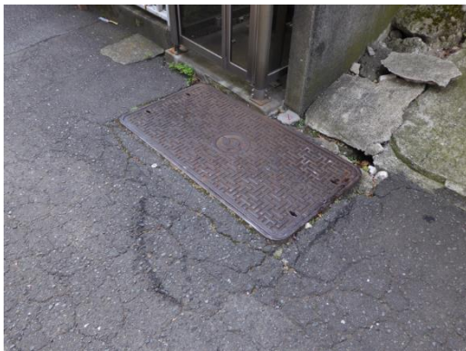
舗装が劣化しているので補修してほしい
