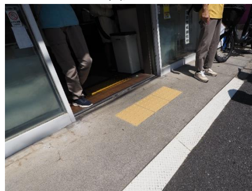
道路と入口の段差をなくすためのステップが滑りやすく傾斜が急
