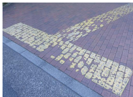
誘導用ブロックの摩耗、劣化
