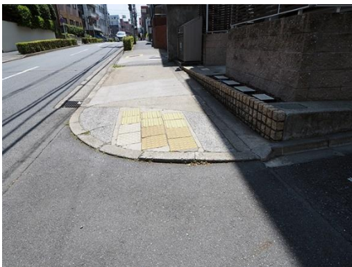
歩道と車道の境の段差を改善してほしい
