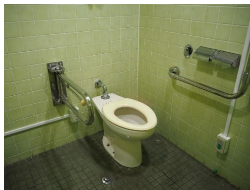
トイレが古いので改修をして欲しい
