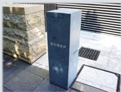
写真 災害時に利用可能な井戸の設置例(中野区)
