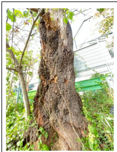
①根元から幹の樹皮枯死・腐朽
