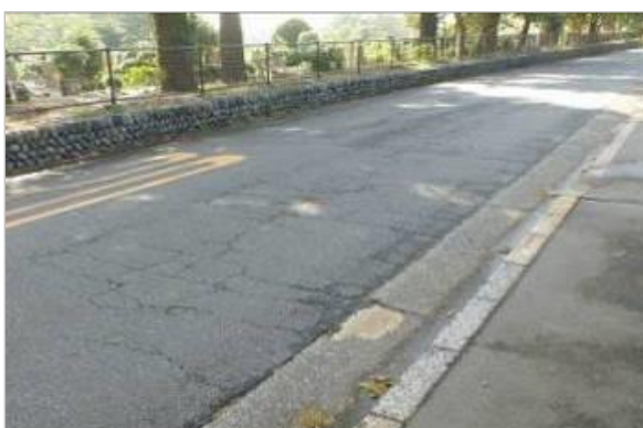
MCI3 相当の劣化状況 (ひび割れが全体的に見える)
