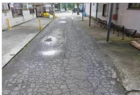
MCI2 相当の劣化状況 (ひび割れが激しくわだち見える)
