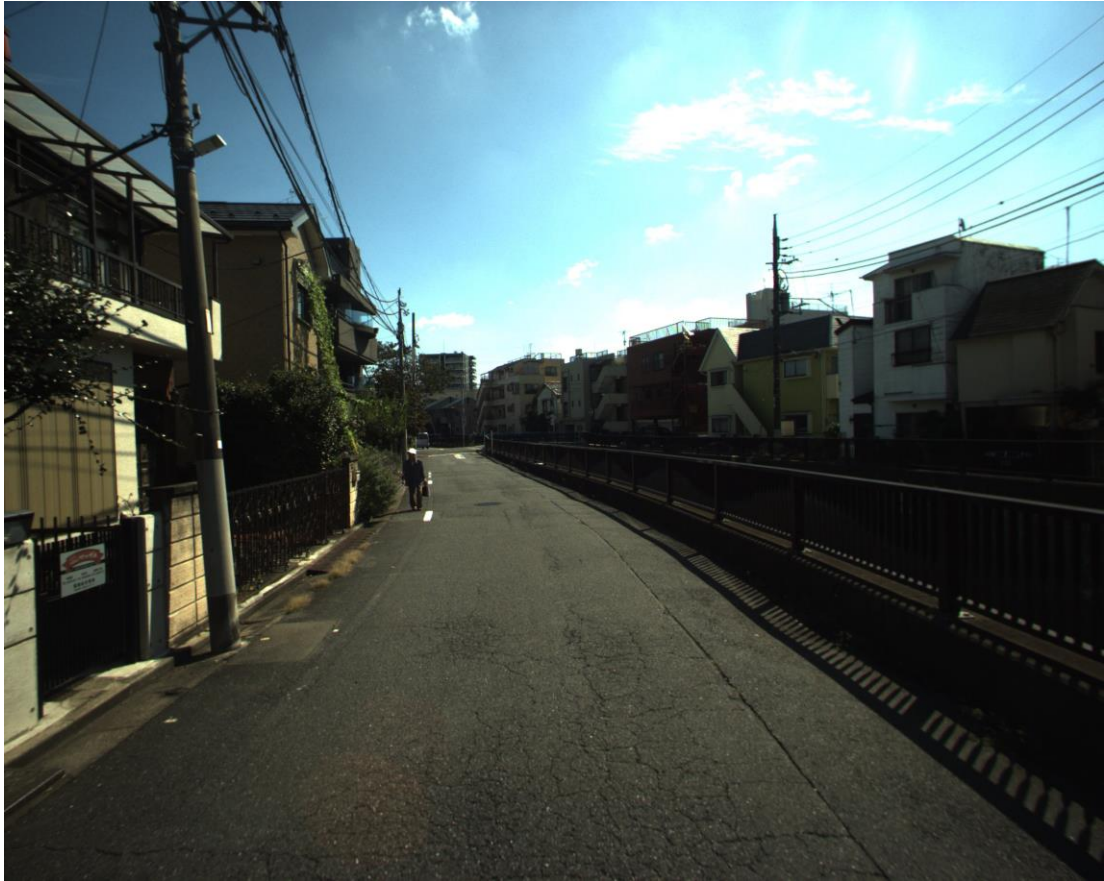
図 2-7 補修が必要な路面状況 (MC I 4.0 以下相当)
