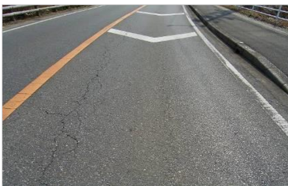
MCI5 相当の劣化状況 (ひび割れが一部見える)
