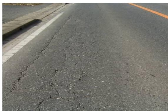
MCI4 相当の劣化状況 (ひび割れが複数見える)
