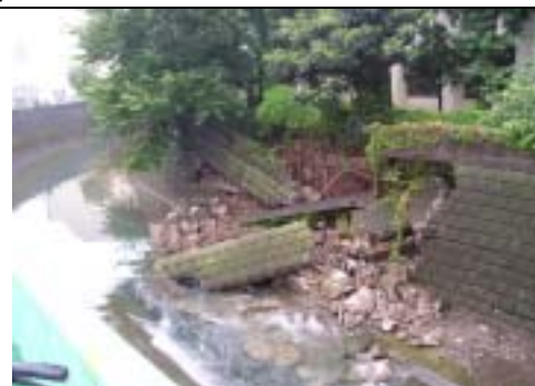
三谷橋護岸崩壊
