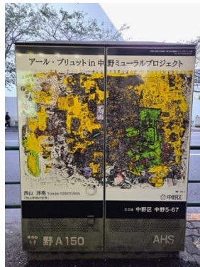
配電地上機器のラッピングに作品を使用
