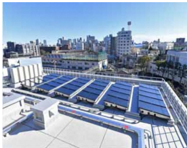
清掃事務所南中野事業所太陽熱設備
