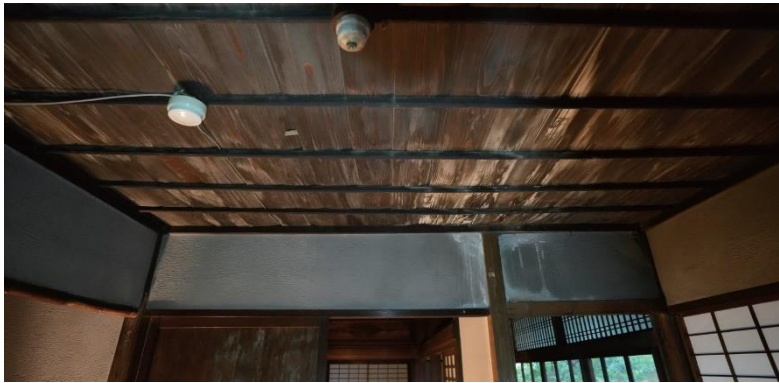
写真1 天井及び垂壁の雨染み
