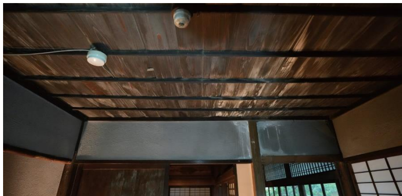
写真2 天井及び垂壁の雨染み
