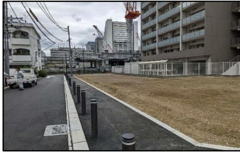
状況写真①
