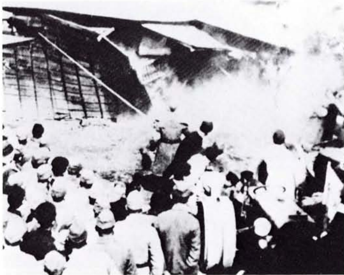
●屋根に绳をつけていっしょに引っばって倒す。建物疎開工事には、人夫のほかにも町会や学生たちも動員させられ、手伝われた (19年 新井町付近)
