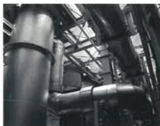
プラント配管
