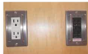
太陽光発電による非常用電源
