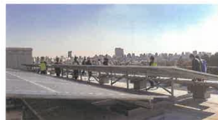
屋上設置のソーラーパネル(非常用電源)
