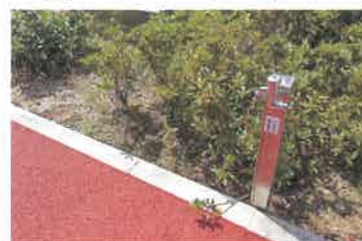
防災井戸の蛇口(飲み水ではない生活用水)
