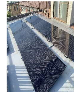
太陽光パネル
