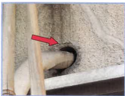
エアコン配管の壁貫通部分 (パテがはがれている)
