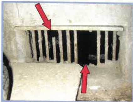
床下通風口の破損
