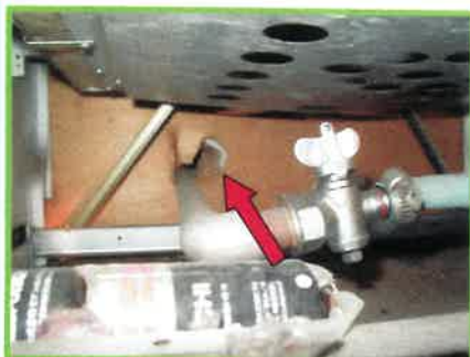
コンベック点検口内部により配管まわりに隙間が
