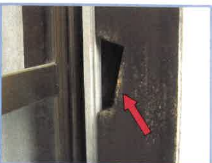
雨戸の戸袋から壁の内部へ 侵入することが多い
