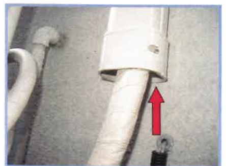
配管にカバーがついている場合 開口部に注意
