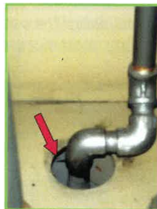
流し台下の排水管まわり
