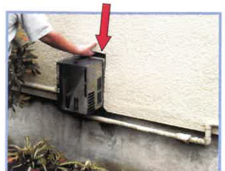
バランス釜排気口の上部
