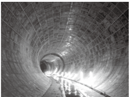
▲内径8.5mの貯留管
