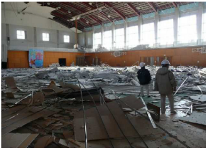
天井の地震被害
