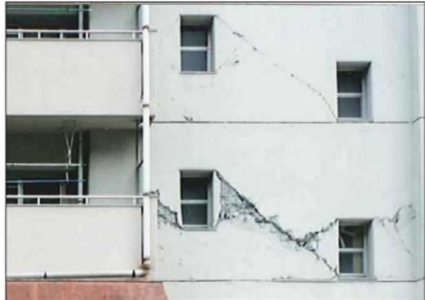
大きなひび割れ(幅2mm以上)
