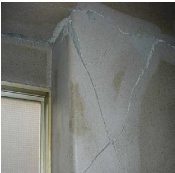
大きなひび割れ(幅1~2mm)
