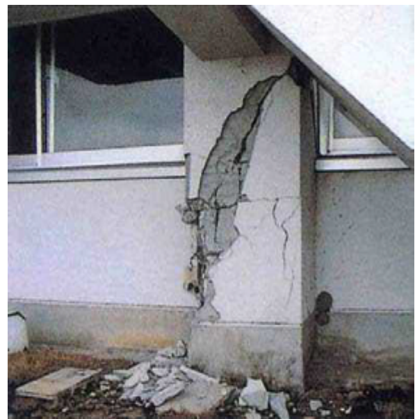
大きなひび割れ(幅2mm以上)
