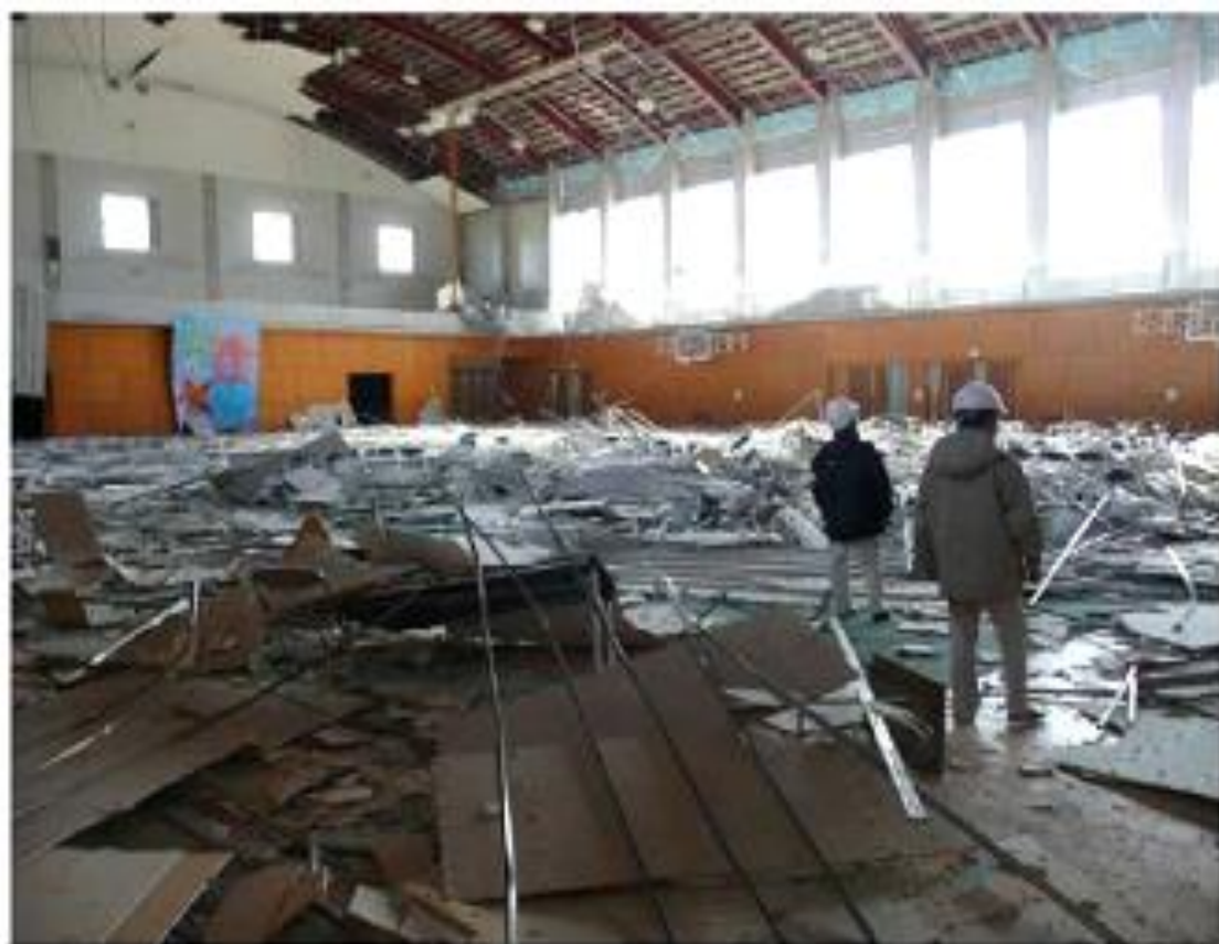
天井仕上げ材が散乱した 体育館内
