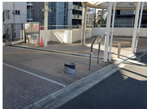
誘導用ブロックの設置不足
