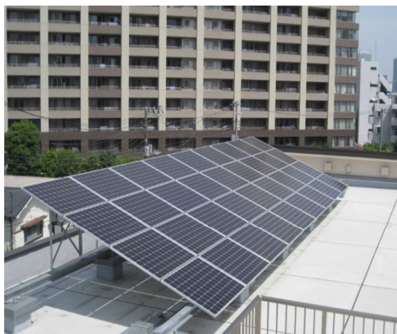
東中野区民活動センター(太陽光設備の導入例)
