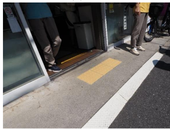
道路と入口の段差をなくすためのステップが滑りやすく傾斜が急
