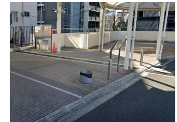
案内板への経路に誘導用ブロックを設置して欲しい
