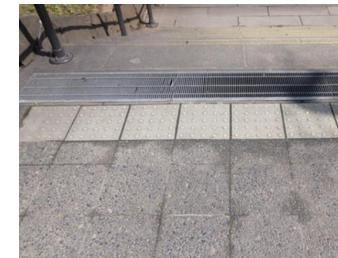
誘導用ブロックを黄色のブロックに改修して欲しい
