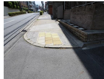
歩道と車道の境の段差を改善して欲しい
