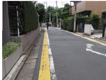
路側帯のカラー舗装が劣化している
