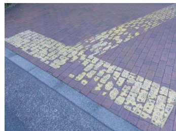
誘導用ブロックの摩耗、劣化
