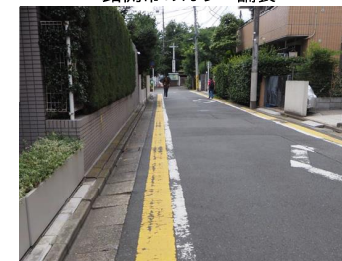
路側帯のカラー舗装が劣化している
