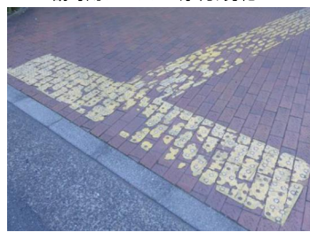
誘導用ブロックの摩耗、劣化
