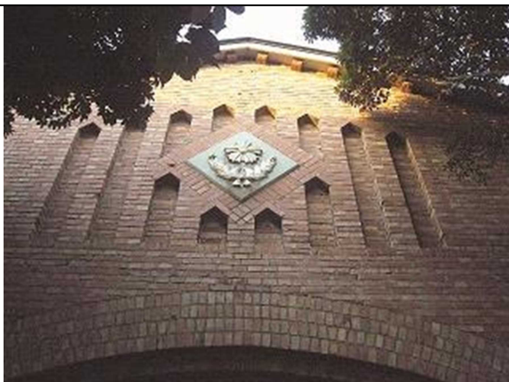
写真5 正面入口上部の仕様
