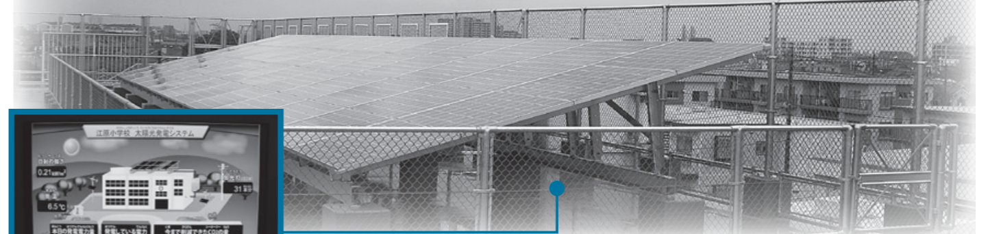
▲屋上に設置された太陽光発電パネル(上鷺宮小学校)
